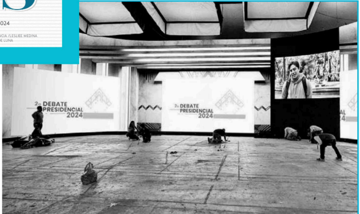
DINÁMICA | • El set para el segundo debate presidencial está en proceso de construcción en los Estudios Churubusco.
