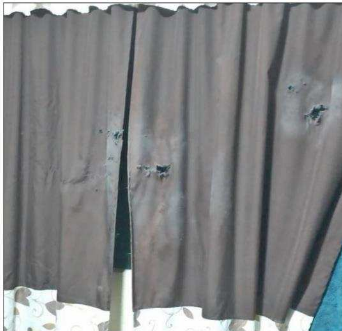
◀ Las cortinas del inmueble muestran los impactos de las balas. Foto Especial
