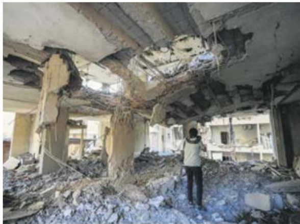
Bombardeo. Un fotógrafo documenta los daños en un edificio.
